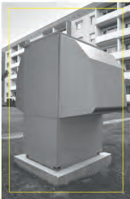
Über diese Luft-Wasser-Wärmepumpe mit einer Leistung von 25 kW werden 40 Wohnungen mit Warmwasser versorgt.
