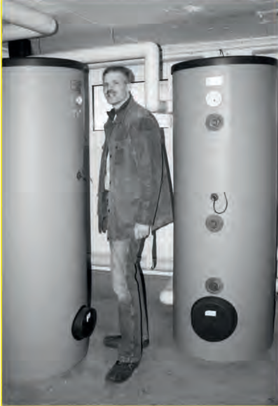
Abteilungsleiter Frank Schunack verdeutlicht die Kesselgrößen der WP-Heizungsanlage – sie passt bequem in jeden Keller.
