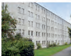
Der Zustand der Fassaden vor der Sanierung ...
