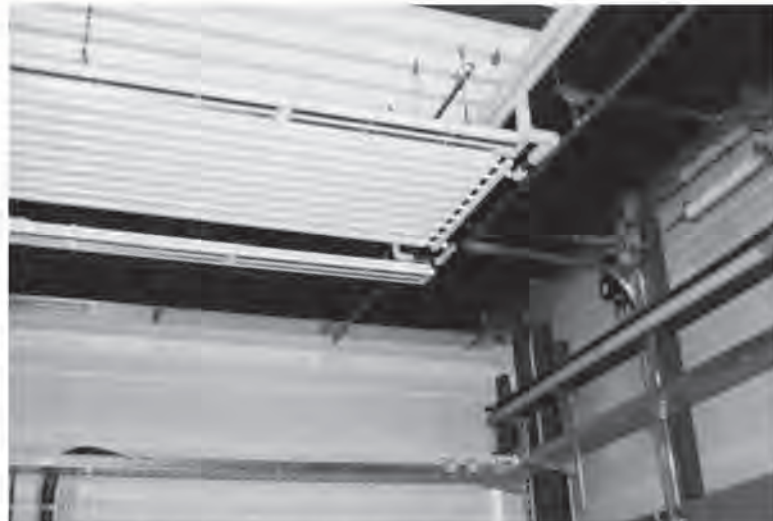
Dank der Anordnung der Wärmeverteilung an der Decke wird der Produktionsbetrieb nicht eingeschränkt.
