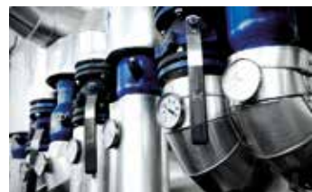
Das neue BHKW beheizt künftig den gesamten Standort
